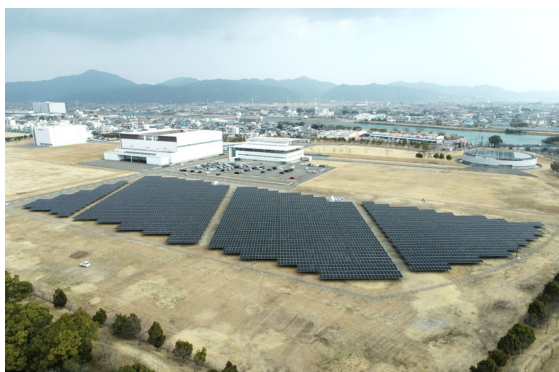
北島工場に設置した太陽光発電設備
